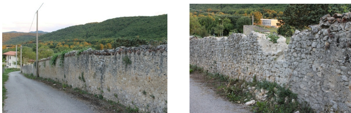
Muro danneggiato dal sisma lungo Via Castelnuovo a San Nicandro
